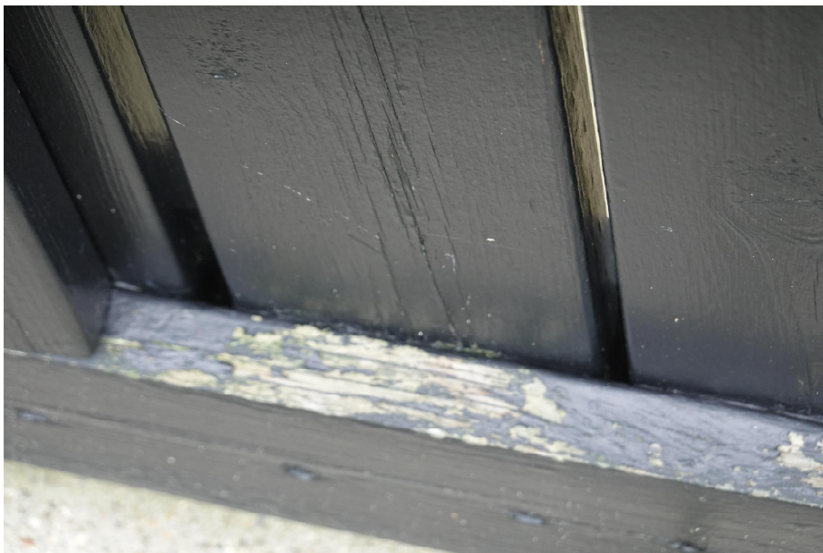
Foto 9 Konstruktionsdetalje der ikke tager hensyn til vandpåvirkning af plankeværk. Vandet opsamles ved den vandrette liste med nedbrud til følge.
