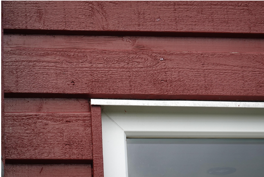
Foto 4 Detalje af inddækning over vindue. Der er ikke afsat plads til ventilation af den bagvedliggende konstruktion.
