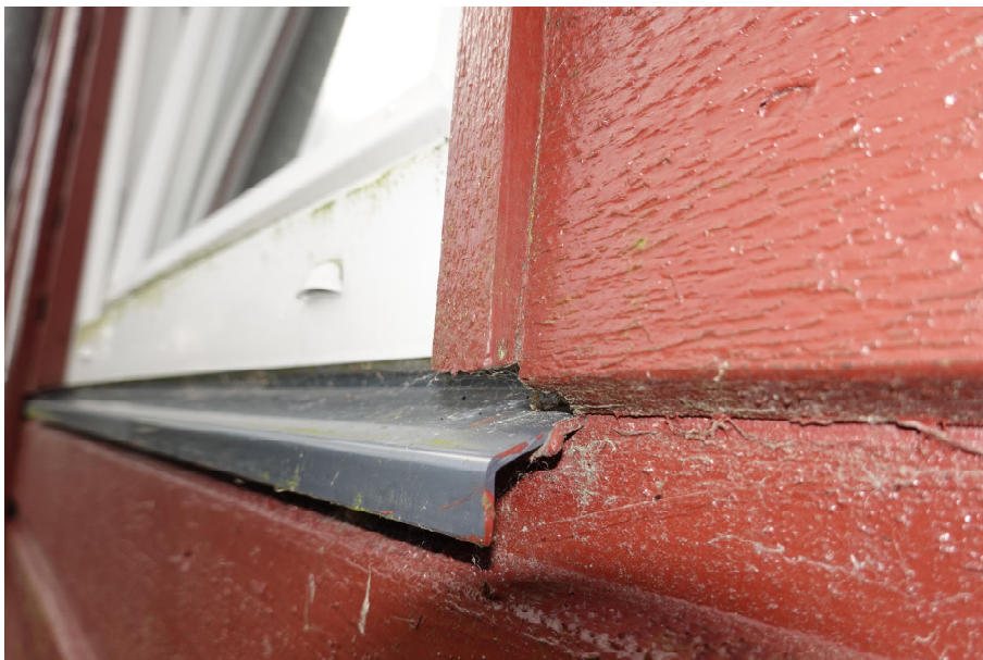
Foto 5 Detalje af inddækning under vindue. Der er ikke afsat plads til ventilation af den bagvedliggende konstruktion.
